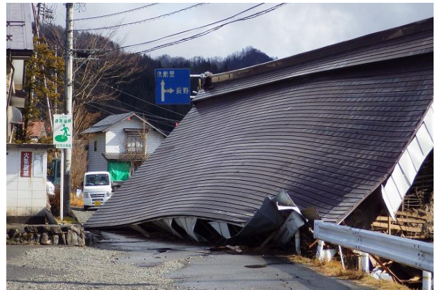
屋根が崩れ落ちた建物（白馬村堀之内地区）
